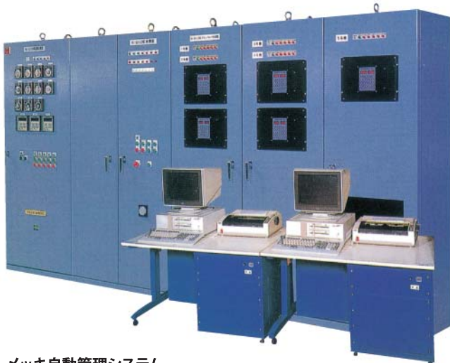
メッキ自動管理システム
